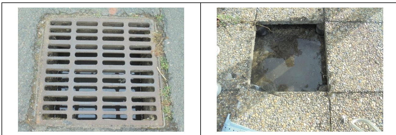
Figure 14 - Deux situations constructives favorables au développement du moustique tigre (difficulté de drainage des regards ou des espaces sous dalles sur plots)
